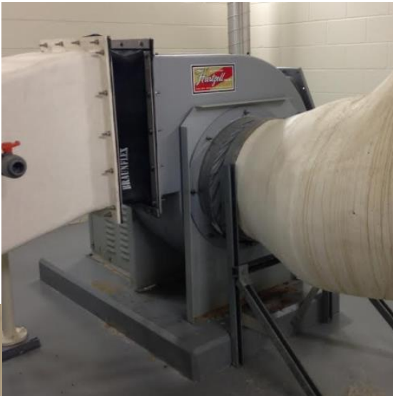
Biosolids scrubber fan
